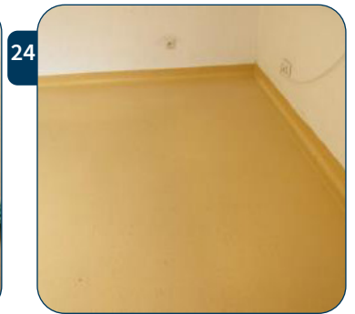
24 De vloer moet een egale kleur hebben en een mat uitzicht hebben. Er mogen nergens glanzende plekken zijn!
